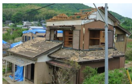
図1: 強風による住宅被害例
