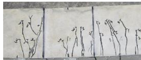
図2 FRCC のひび割れ状況
